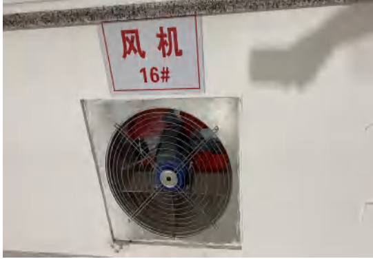
图6-7 110kV 配电装置室内通风
